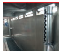
Absaugung des Ölnebels und der Kühlflüssigkeit
