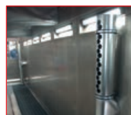
Absaugung des Ölnebels und der Kühlflüssigkeit
